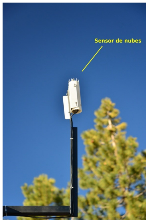
Figura 1: Instalación del Sensor de Nubes Clarity II.
