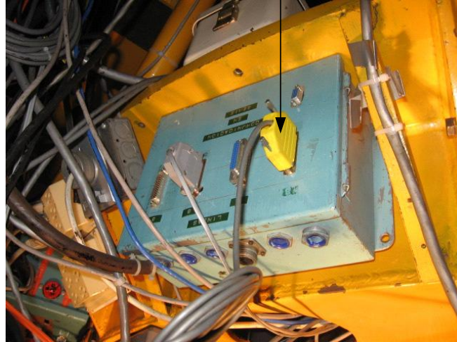
Figura 11: Tablero de conexiones serie de platina.
