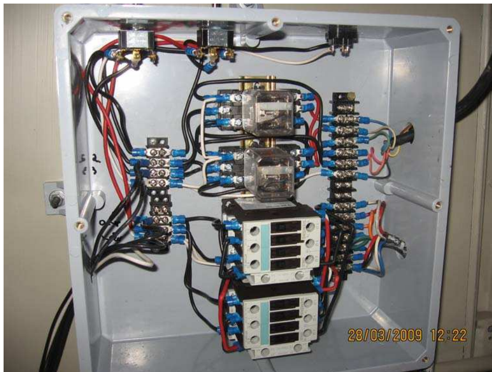
Figura B.2. Imagen de la caja de contactores.
