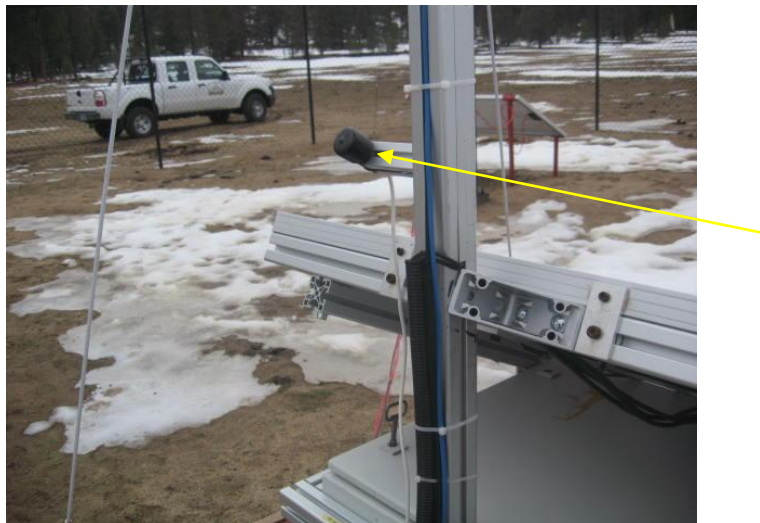
Figura 15: Cámara con protector en el sensor de luz.
