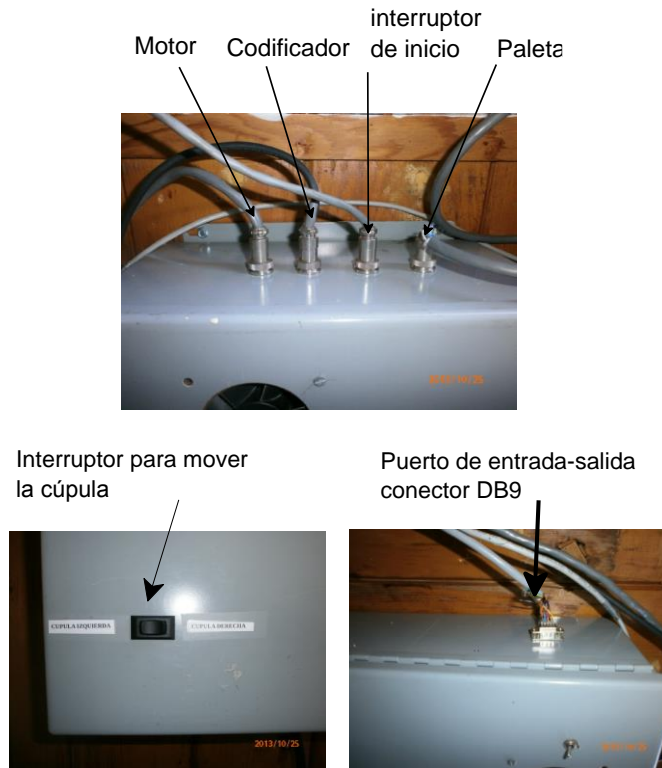
Figura 5: Vista exterior del gabinete del manejador de motor de cúpula y tarjeta de relevadores.
