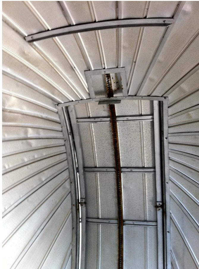
Figura 14: Parte superior de la cúpula, cortina y anclaje del mecanismo de apertura de la cortina.
