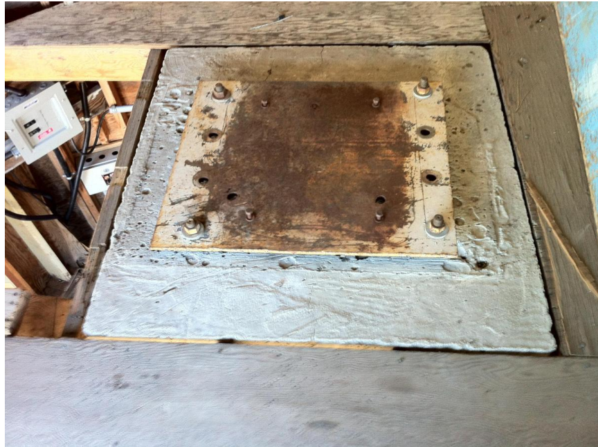
Figura 6: Vista de la parte superior del pilar y la placa de Tip-Tilt.
