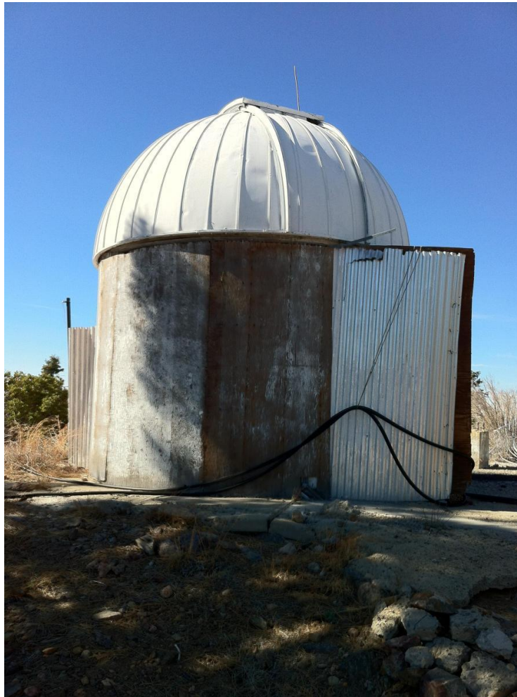
Figura 3: En esta fotografía desde el Sur, se observa parte del forro de triplay de la estructura; las láminas corrugadas que se ven a ambos lados pertenecen a un segmento de la pared exterior del edificio que albergó al telescopio SPM84. Este segmento continúa por dentro de la construcción y sobresale por ambos lados.
